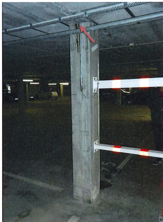
Foto 8: Søjle med vandindtrængen ved dæksamling.
