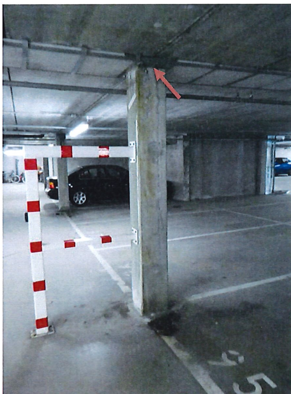
Foto 7: Søjle med vandindtrængen ved dæksamling.
