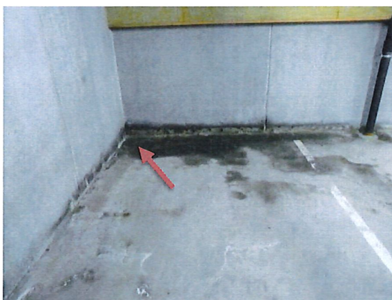
Foto 5: Vand ved samling mellem terrændæk og ydervæg
