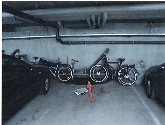
Foto 1: Vand ved samling mellem terrændæk og ydervæg
