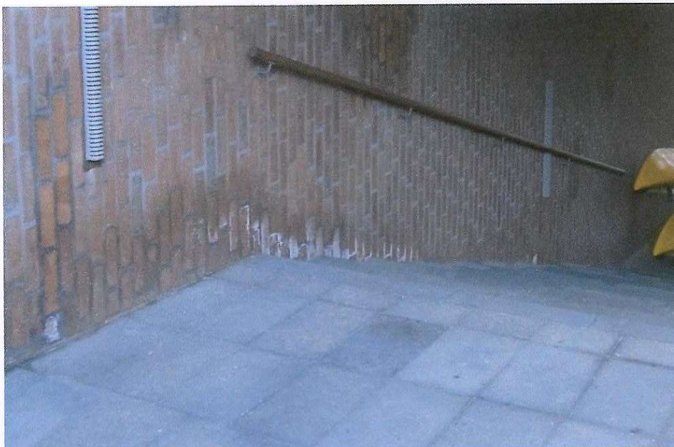
Foto 1 – Saltudtræk i bund af murværk. Murværket ses ført under terræn.
