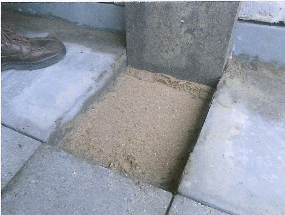
Foto 4 – Ved optagning af flise ses gennemvådt sand under flisen.
